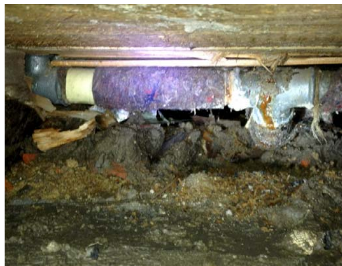
Das defekte Warmwasserrohr in der Zwischendecke. Vom Riss im T-Stück (rechts) leckt in rostiger Spur Wasser herunter.
